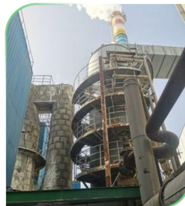
内蒙永和脱硫脱硝废气处理装置
